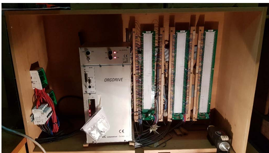
Photo 9 : Le nouveau combineur dans son armoire.
